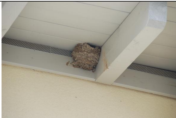
3 Auch Naturnester müssen in Zukunft geduldet werden; Neubau eines Nestes nach Entfernung der Abwehrmaßnahmen
