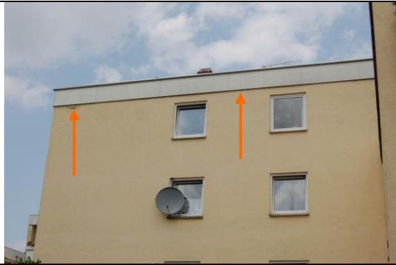
1 Fledermausquartiere und Brutplätze von Mauerseglern unter der Dachrandverkleidung
