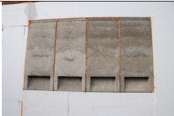
7 Vierer-Quartier für Fledermäuse am gedämmten Dachrand
