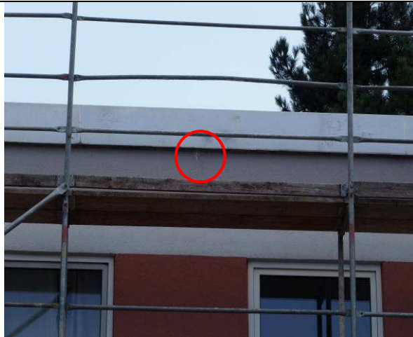
1 Kotspur eines Nistplatzes unter dem Dachblech vor den Dämmmaßnahmen
