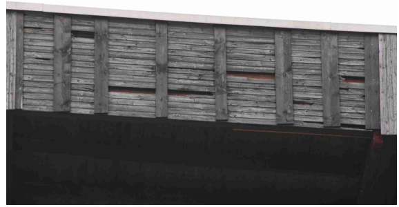
2 Hinter Schadstellen in der Holzverkleidung befanden sich die Nistplätze der Mauersegler
