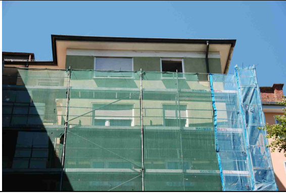
1 Gerüst während der Brutzeit nur bis 3 m unter der Dachtraufe aufgebaut und vernetzt
