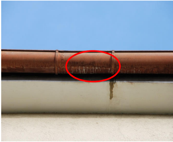
1 Dachrinne mit deutlichen Kotspuren als Hinweis auf den Brutraum der Mauersegler im ungenutzten Dachraum
