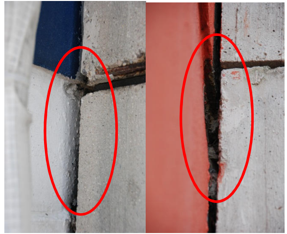
2 Offene Fugen in der Hausfassade, hinter denen sich Brutplätze von Mauerseglern befanden
