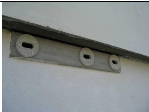
5 Niststeine unter dem Dachrand eingebaut...
