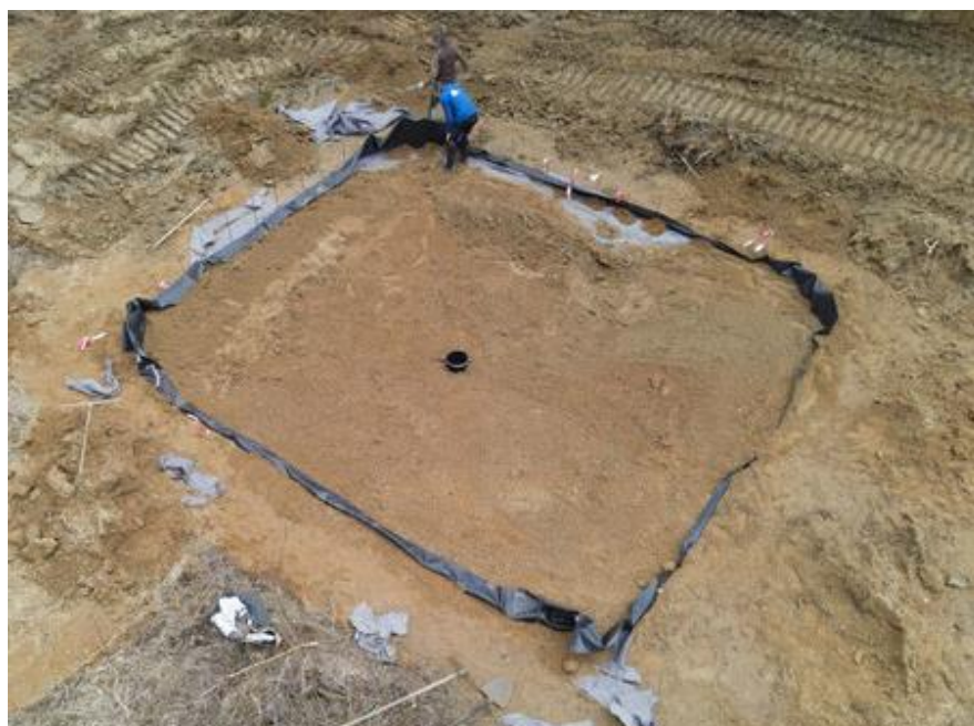
Abbildung 5: Bau eines EPDM-Foliengewässer mit beidseitigem Vliesschutz und mitigem Pumpensumpf - Drohnenaufnahme: C. Mahmoudi
